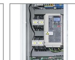
Quadro di manovra Impianto Mrl
